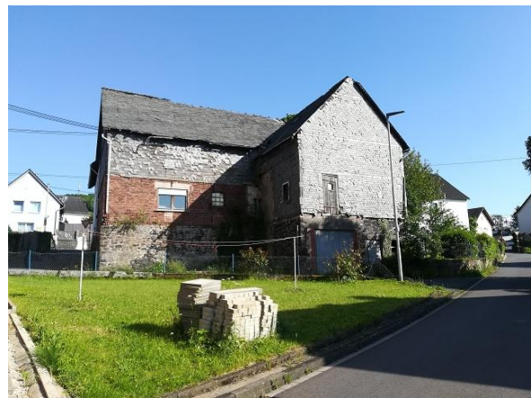
Abbildung 112: Von außen ersichtlicher Sanierungsbedarf in der Gartenstraße im Ortsteil Unnau
