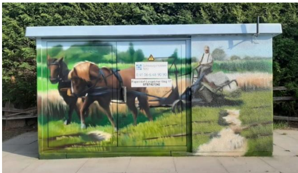
Abbildung 167: Beispiel einer professionell besprühten Transformatorstation Quelle: https://die-sprueherei.de/wp-content/uploads/2020/09/552e26ac-4214-4ad8-b592-a49fa99d393d-1024x590.jpg
