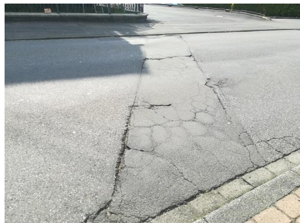
Abbildung 244: Straßenschäden in der Hauptstraße / L 293 im Ortsteil Unnau
