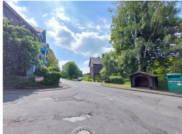
Abbildung 242: Straßenschäden in der Bahnhofstraße im Ortsteil Unnau
