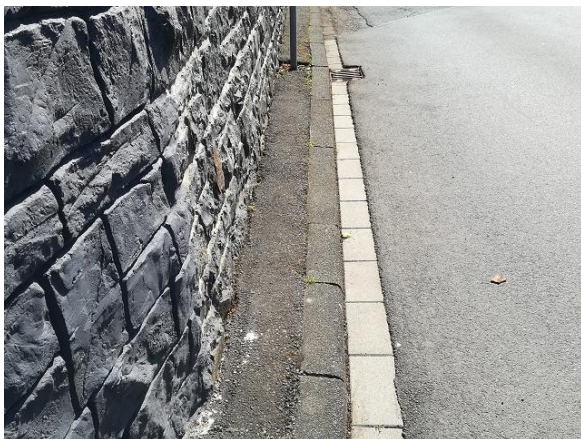
Abbildung 260: Nicht begehbarer Bürgersteig in der Erbacher Straße / K 61 im Ortsteil Unnau
