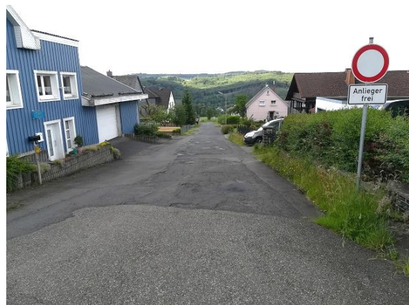
Abbildung 243: Straßenschäden in der Poststraße im Ortsteil Stangenrod
