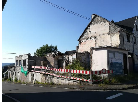
Abbildung 102: Negativ auf das Ortsbild wirkende Brandruine an der Erbacher Straße / K 61 im Ortsteil Unnau
