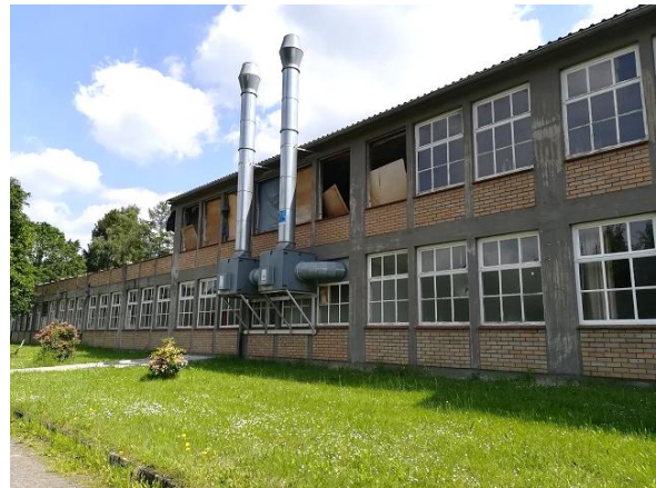
Abbildung 110: Von außen ersichtlicher Sanierungsbedarf an der Bahnhofstraße im Ortsteil Korb
